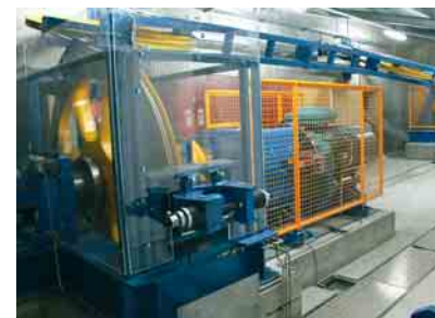
Antriebsstation der neuen Bahn
