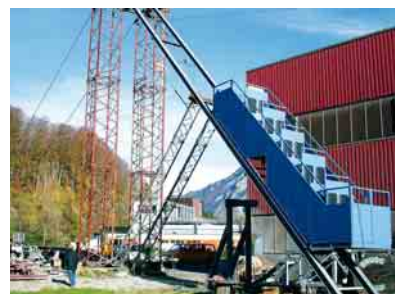
Test der Bergebahn in Schwanden
